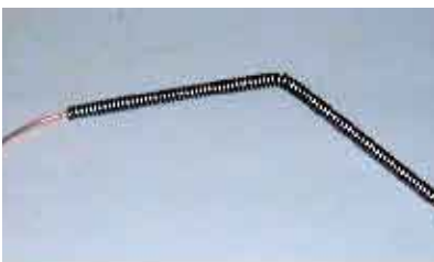
Fig. 3 Conducto Flexible (Liner) quebrado. Exige reemplazo.
